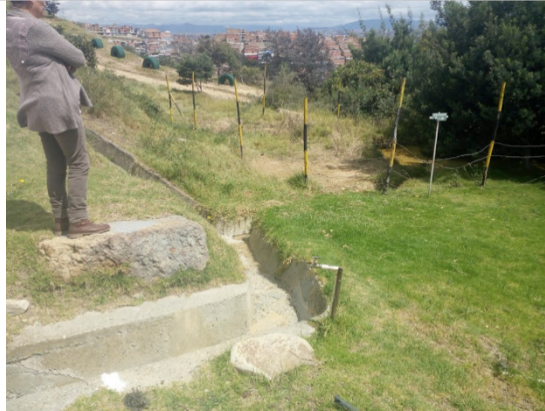
Foto No. 05. Tanque de almacenamiento de Agua de escorrentía
